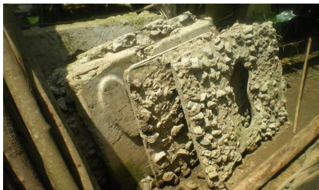
Figure 10: Exemple de dalles ne remplissant pas les normes standards préconisées
